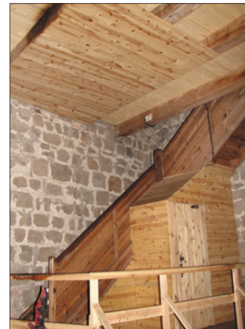
Podbití stropu u schodiště a samozavírací dveře.
