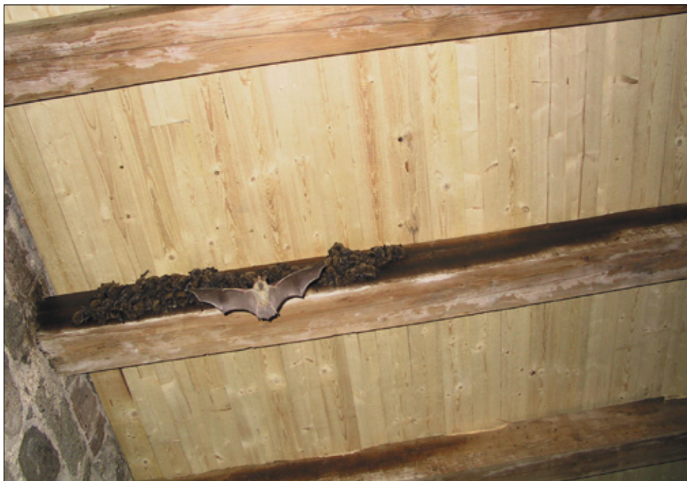
Pohled na opravenou podlahu předposledního patra s kolonií netopýřů.
