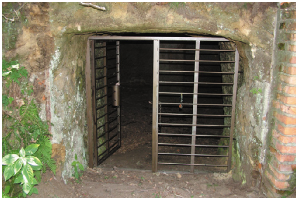
Obr. 18 Příklad správně zabezpečeného vstupu do sklepení pod zámek Lemberk (foto: Daniel Horáček).
