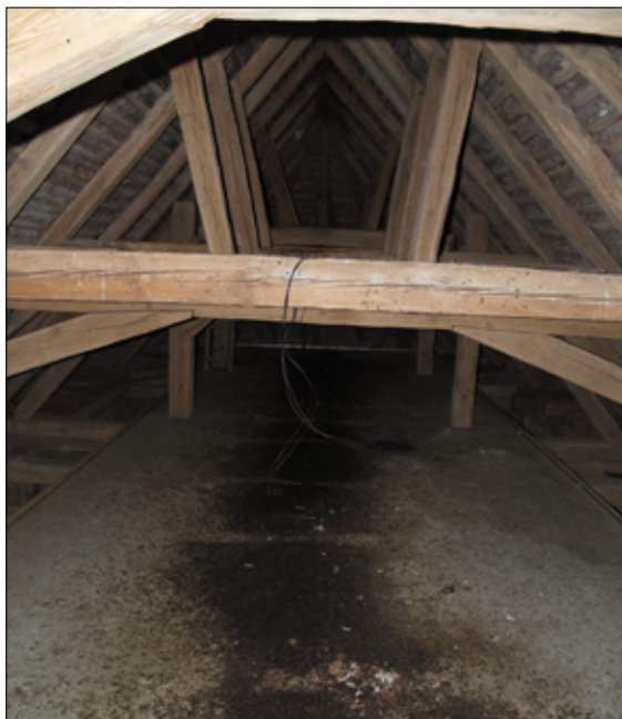
Ochranná podlážka s pozinkovaným plechem v roce 2007.
