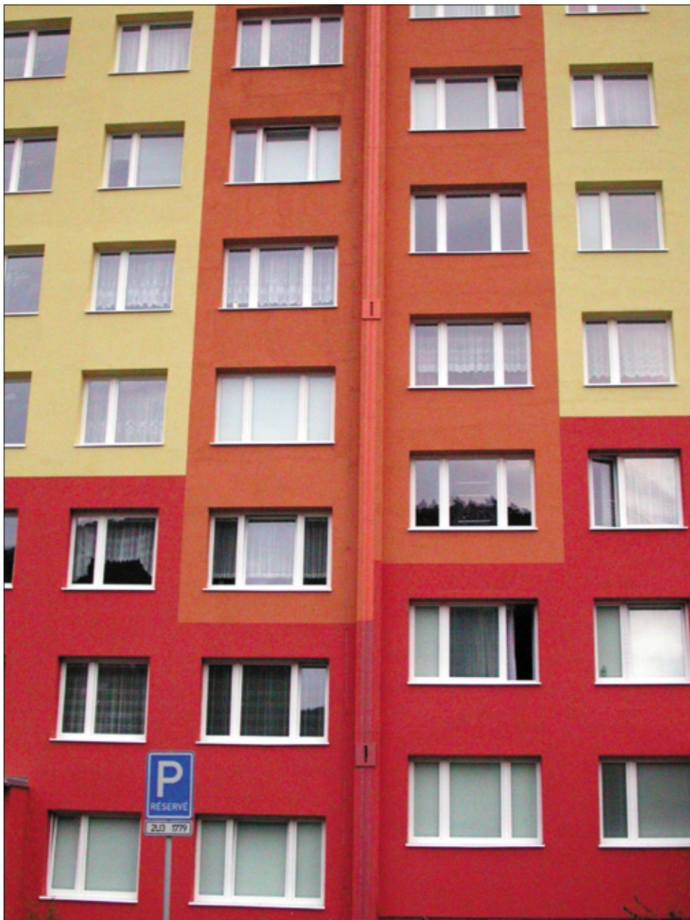
Panelový dům po zateplení s instalovanými průleznými deskami.
