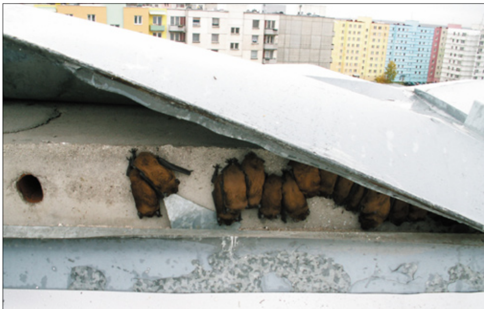
Obr. 20 Netopýři rezaví zimující pod oplechováním atiky, kteří byli odkryti během rekonstrukce panelového domu v Českých Budějovicích (foto: Radek Lučan).
