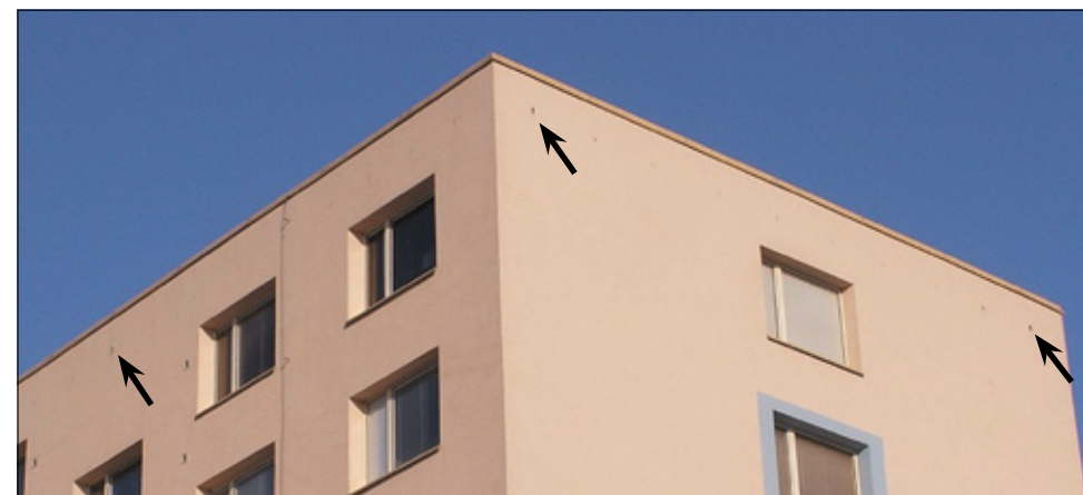
Obr. 28 Panelový dům ve Svitavách. Po zateplení byly ponechány otvory pro netopýře na bocích domu a nad schodišti (foto: Jiří Mach).
