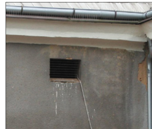
Pohled na okno s uzávěrou proti holubům.
