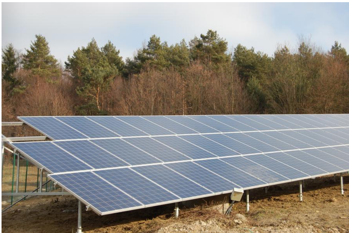
Obrázek 15 - Fotovoltaická elektrárna s majetkovou účastí obce v Hostětíně. Zdroj: El Veronica
