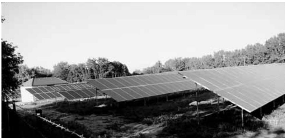
Obrázek 21 - Lužice: Obecní fotovoltaická elektrárna
