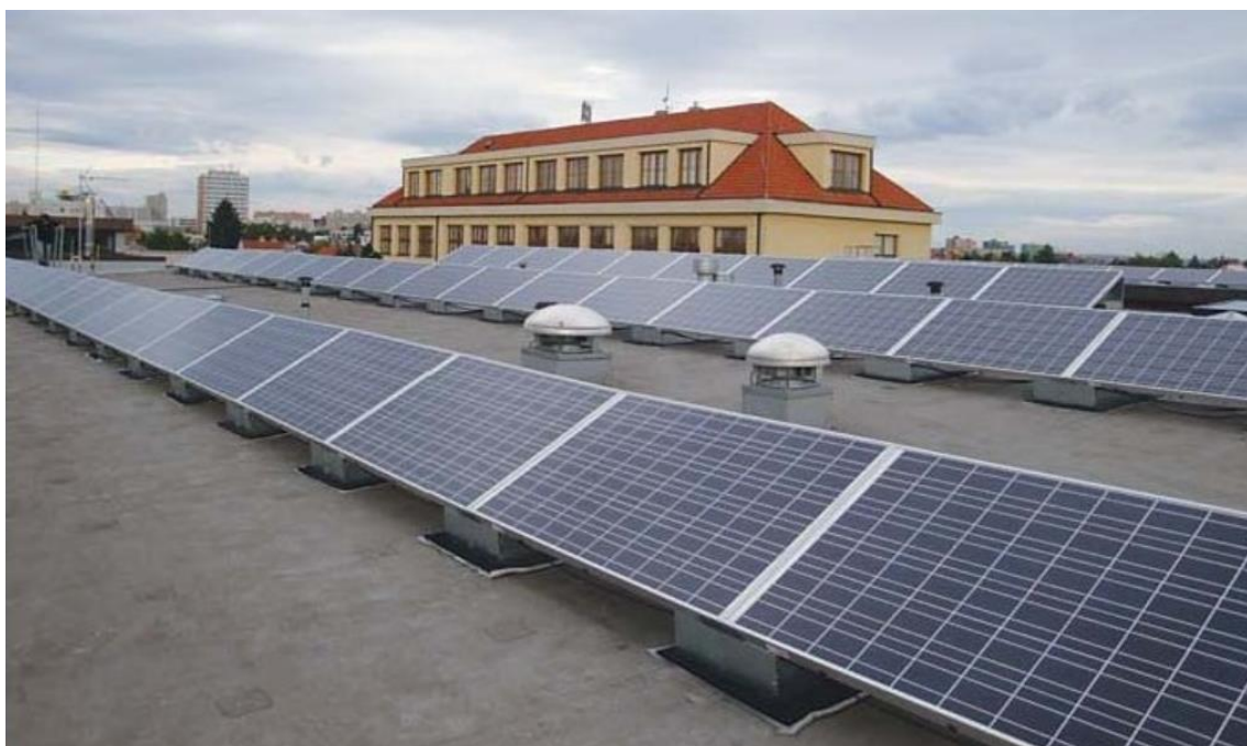
Obrázek 18 - Fotovoltaická elektrárna na střeše ZŠ Kunratice. Zdroj: tzb-info.cz
