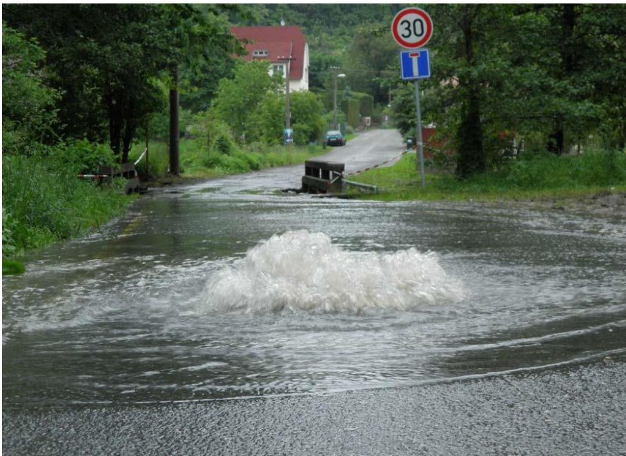
Obr. P3. 4. Přetížená stoková soustava vlivem enormního přítoku srážkových vod, naředitě srážkové vody a splašky vyvěrají z kanalizace na povrch v urbanizovaném území (Fulnek, 2016) – Fotoarchív autora
