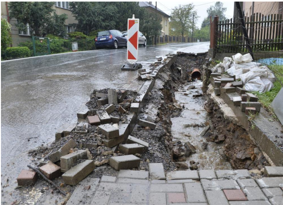
Obr. P3. 3. Enormní přítok a tlak přívalových srážkových vod ve veřejné stokové síti část stoky ve špatném technickém stavu roztrhal a voda tak vyvěrala na povrch urbanizovaného území obce Zaječí, 2020 (iDnes.cz)
