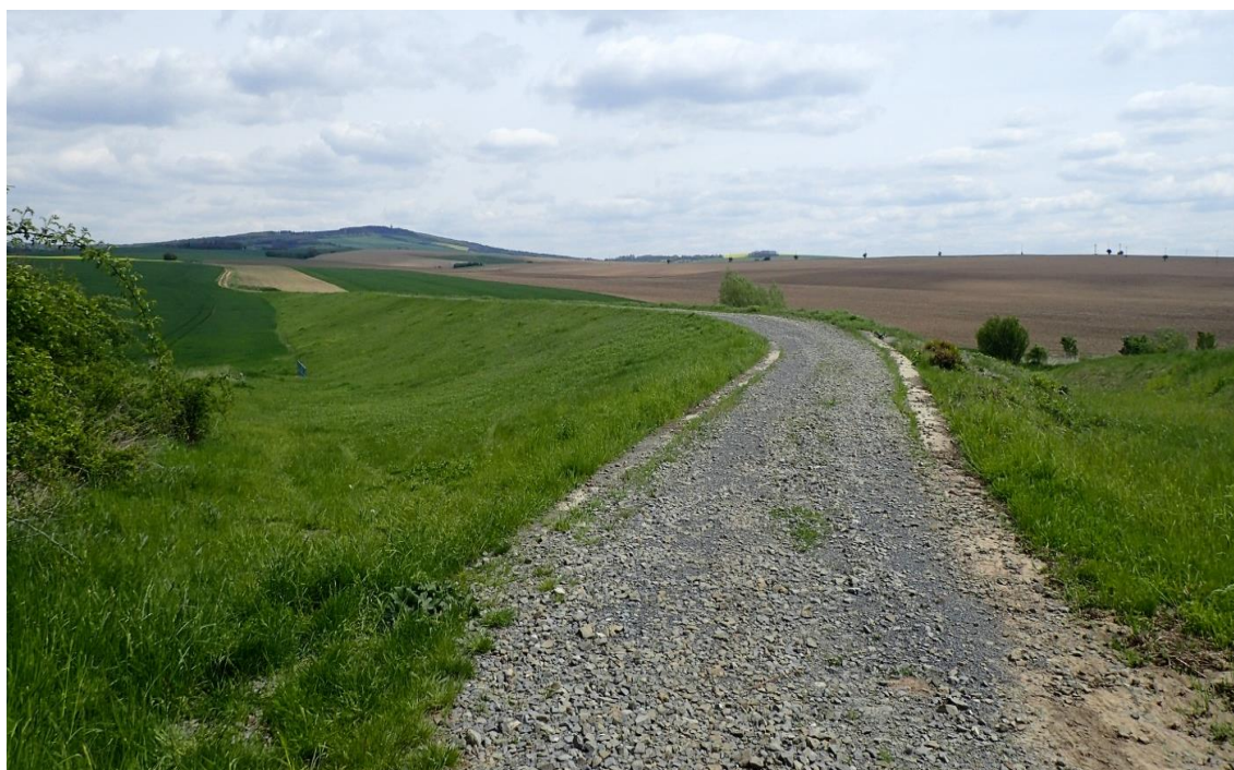
Hráz suché protékající retenční nádrže "Roštoutky" s bočním kamenným bezpečnostním přelivem se zatravněnou zátopou v k.ú. Uhřice (okres Vyškov) (zdroj: VÚV TGM, v.v.i.)
