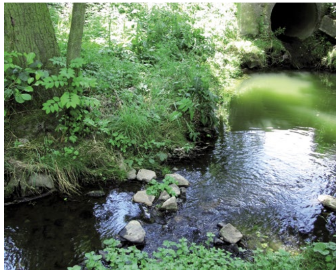
Obr.25: Výpust dešťové vody do potoka
