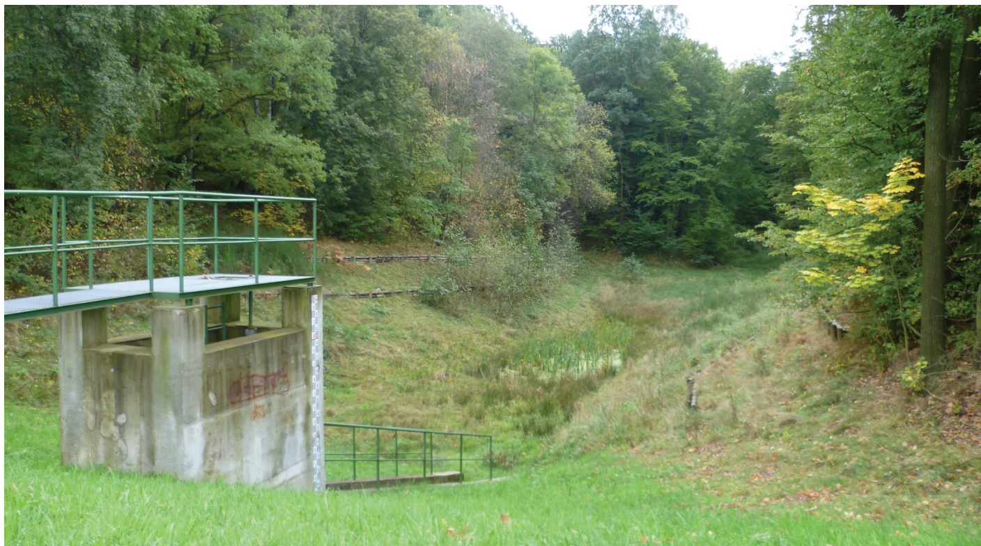
Obrázek 7: Suchá retenční nádrž
